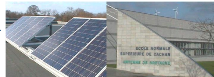
Système expérimental éolien-photovoltaïque (1,5 kW et 2 kW) couplé au réseau et associé à 15 kWh de batteries.
